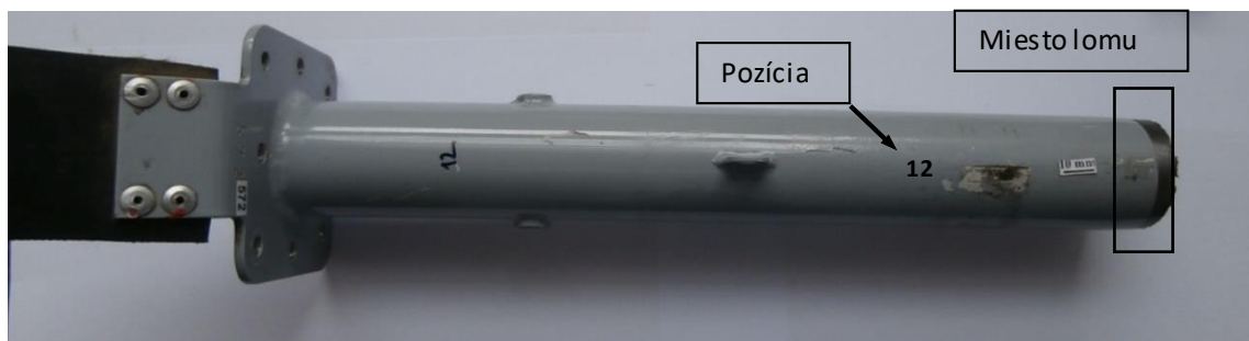
Obr. 2 Dolný fragmentu (D) stojiny podvozkovej nohy
