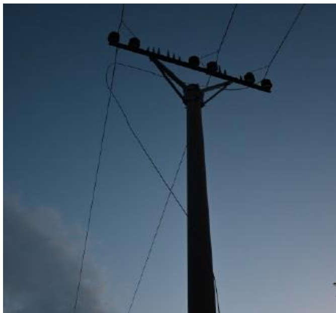
Obr. 5. poškodený vodič vysokého napätia
